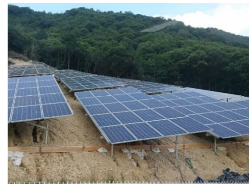
排水施設が適切に設置されていないことによるパネル下の浸食事例(林地開発許可対象外)
