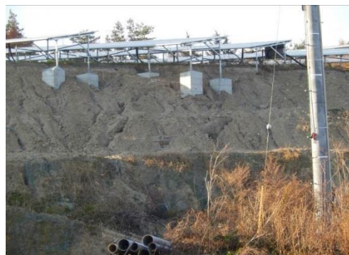
排水施設が適切に設置されていないことによる架台の浸食事例(林地開発許可対象外)
